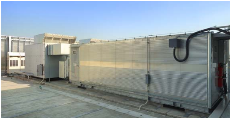
コンテナ型データセンターモジュール「IZmo」
