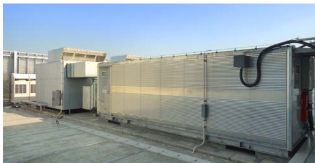
コンテナデータセンターモジュール「IZmo」
